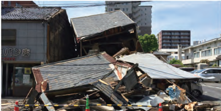
地震によって倒壊した熊本市内の建物
