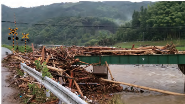
流木が絡まる日田彦山線の橋脚
